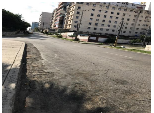
首都ハバナ市内の道路（ひび割れ）
