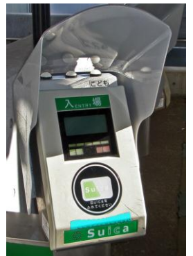
ホーム内に設置された Suica 読み取り機
