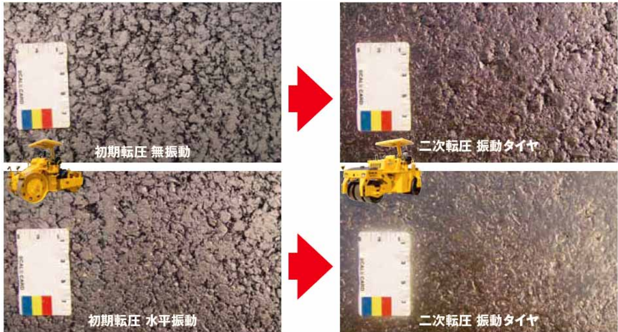
図3 橋梁部の基層 SMA 転圧効果 (二次転圧は振動タイヤローラを使用)
